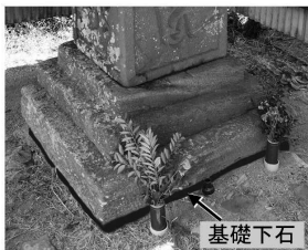
基礎下石(グレーマーキング部) ほとんど埋没している
